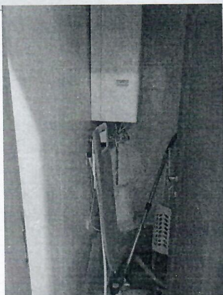
پکیج دیواری داخل واحد
